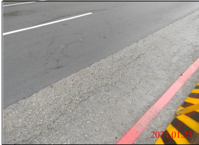
巡查日期地點：113.01.25/ Y23車站 照片說明：路面龜裂狀況
